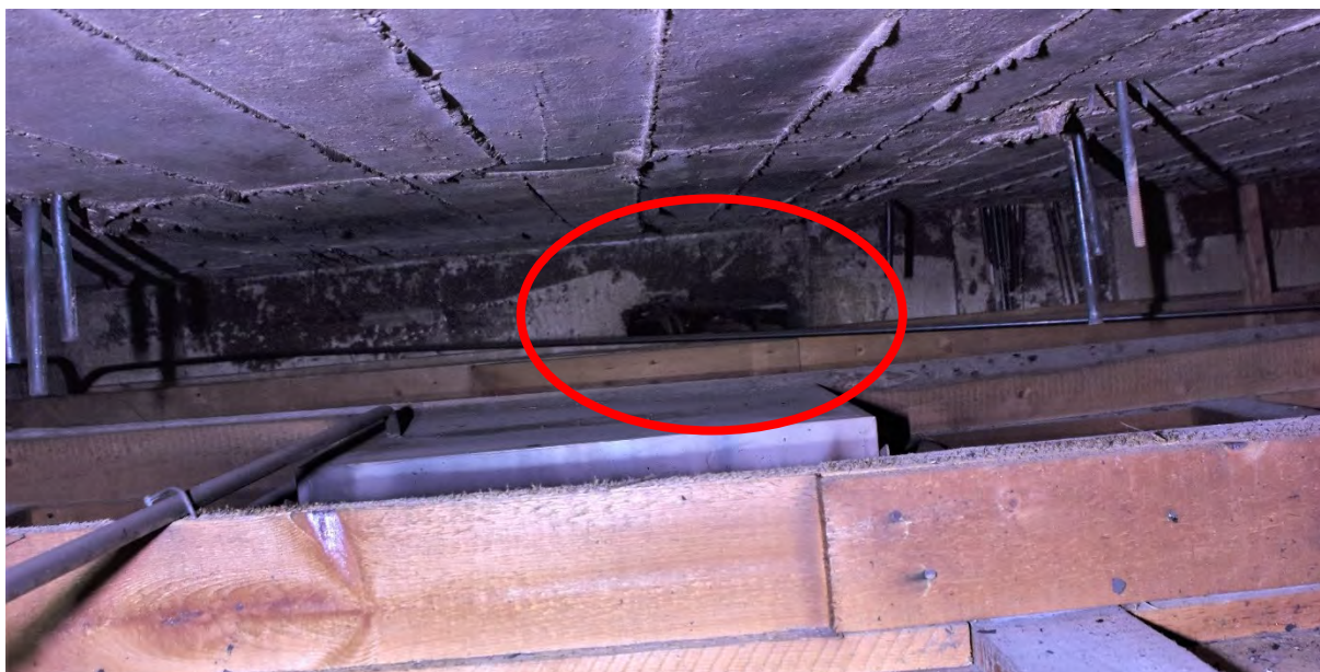
Figur 9. Otät genomföring ovan undertak i livsmedelsbutiken mot hotellets restaurang.
