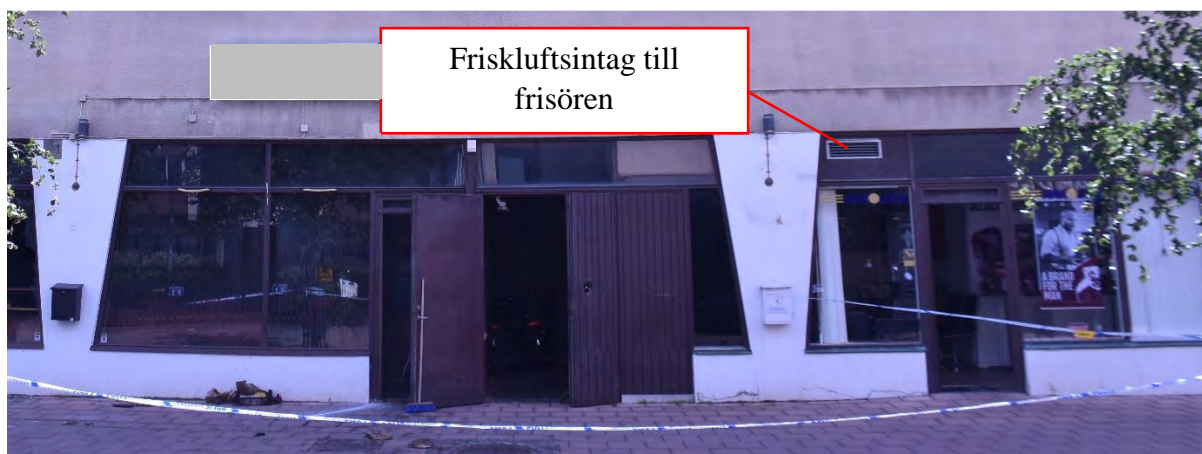
Figur 8. Utsidan mot Torggatan som visar friskluftsintaget där rök kan ha kommit in till frisören.
