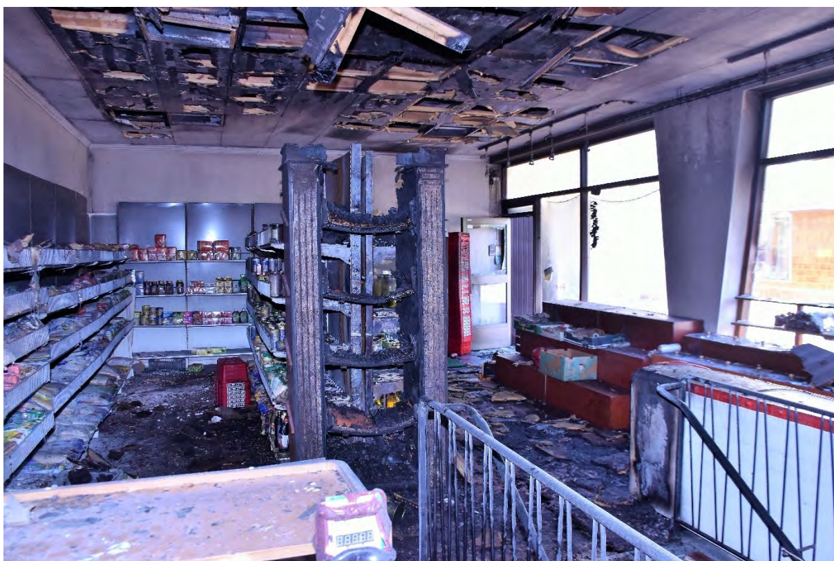
Figur 5. Invändiga brandskador. Brandskadorna på hyllan i mitten av bilden tyder på att branden varit som kraftigast i detta området. Taket är som mest brandskadat ovanför hyllan.
