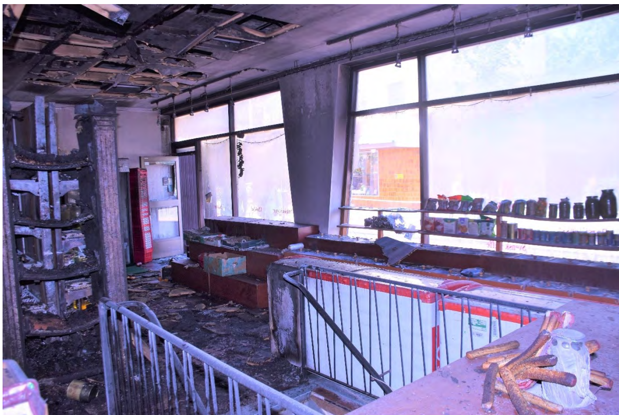
Figur 4. Invändiga brandskador. Det trasiga skyltfönstret syns i mitten av bilden.
