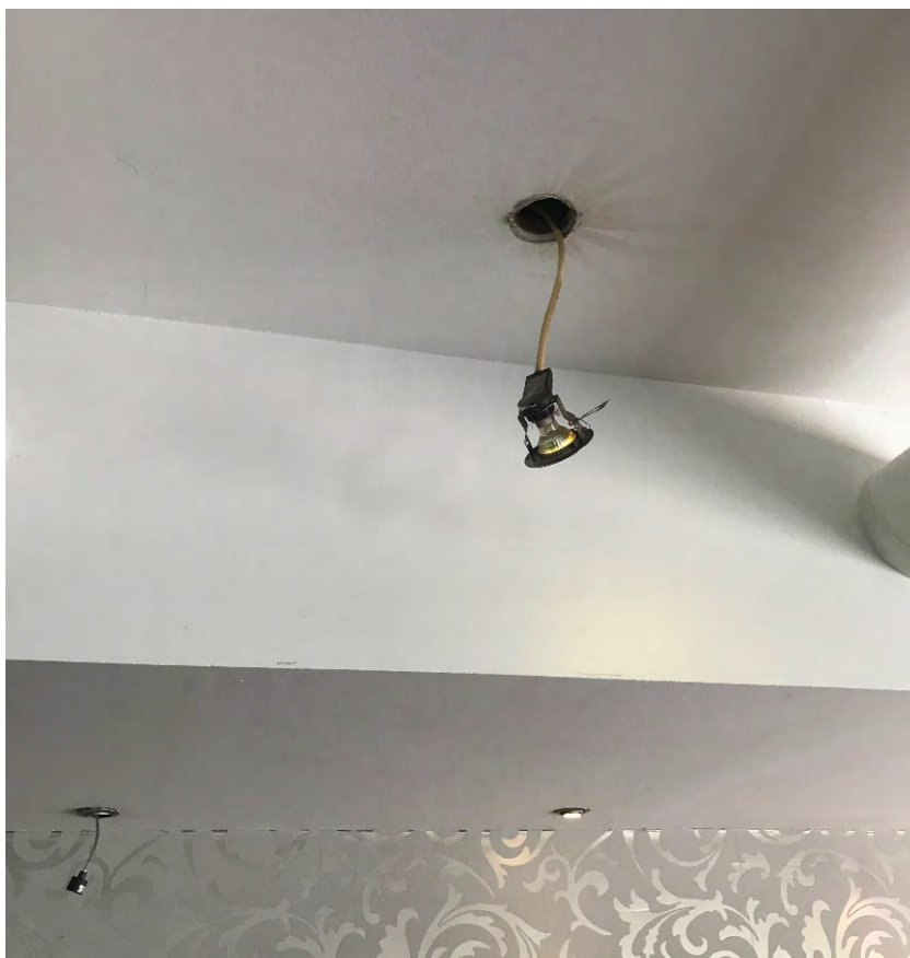
Figur 7. Spår av sot efter att rök har tryckts ut från en infälld spotlight.
