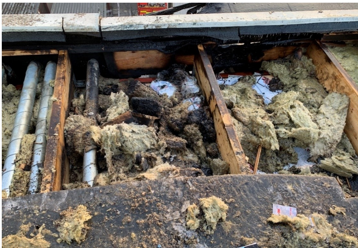
Figur 18. Genombränning till den brännbara takkonstruktionen i hus 13, i anslutning till begränsningslinje
