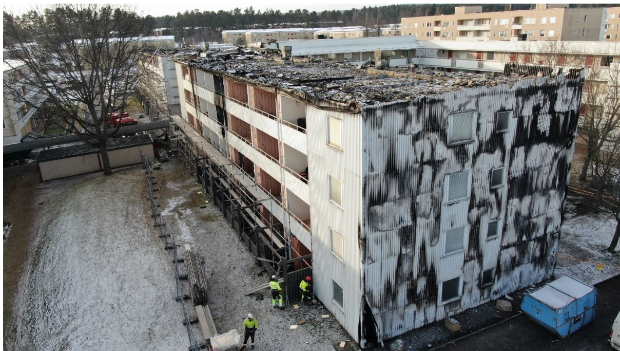
Figur 16. Brandskador på tak och fasad, huskroppen närmast i bild är hus 15, foto taget från norr.
