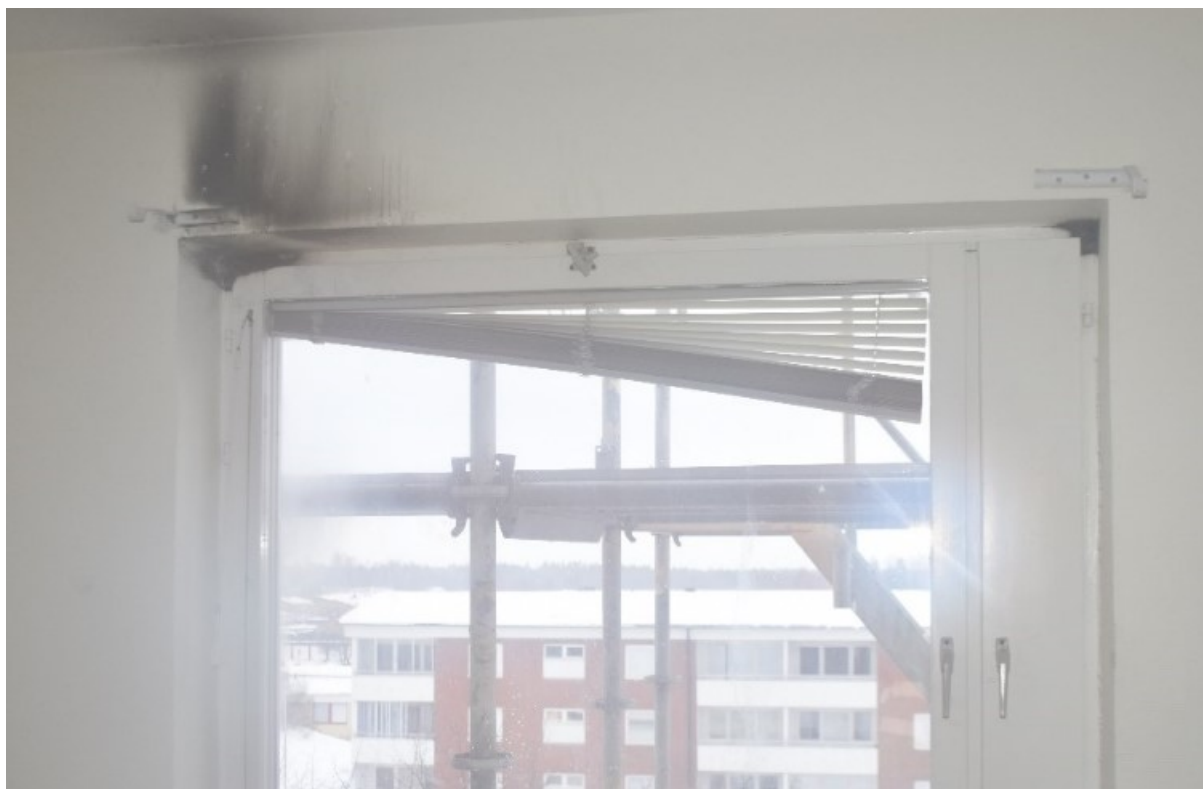
Figur 17. Brandskador i anslutning till fönsterkarm i gavellägenhet.
