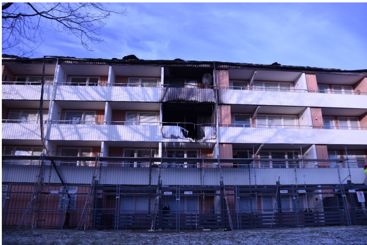
Figur 12. Brandskador på balkong i byggnadens östra fasad.
