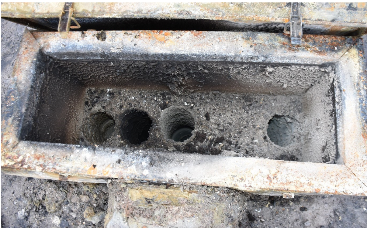
Figur 4. Samlingslåda för frånluftskanaler.
