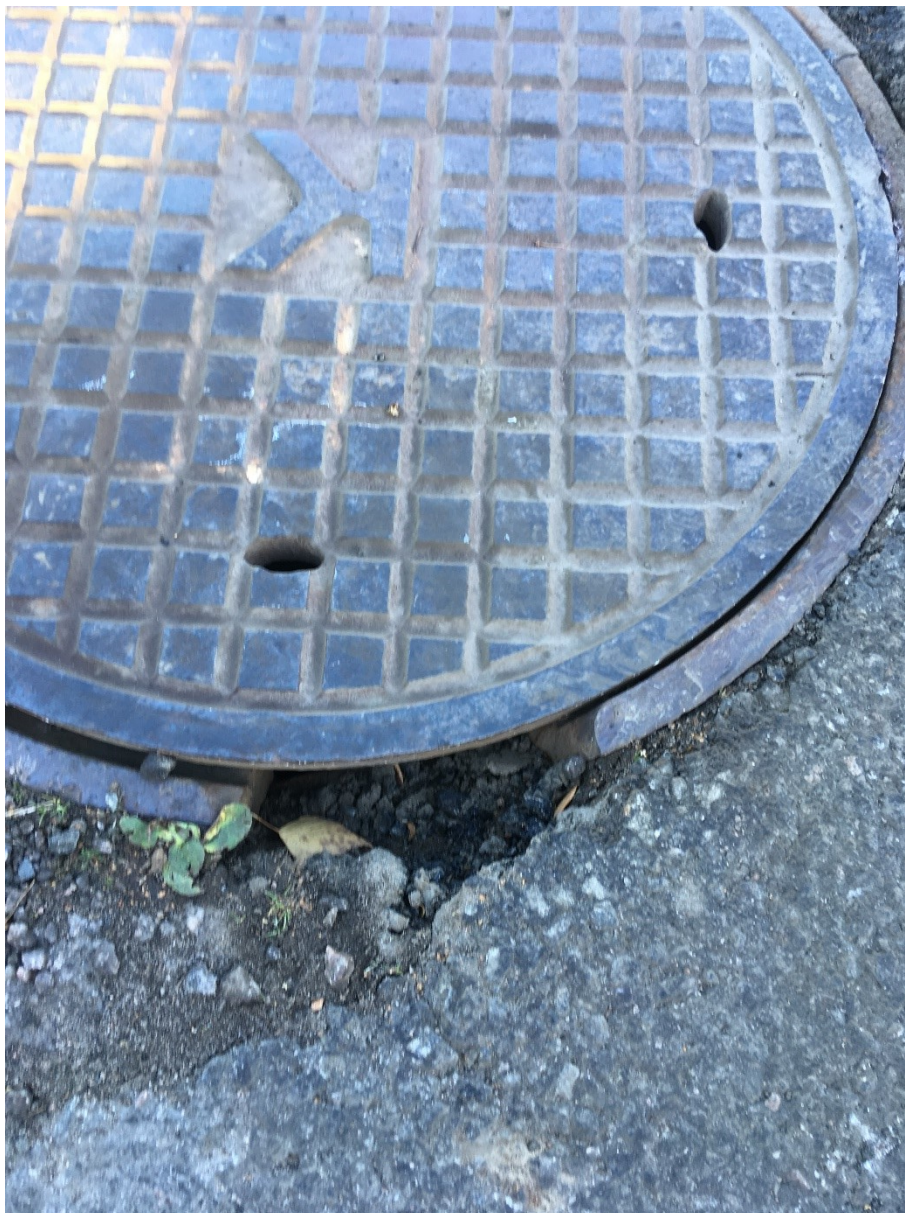
Figur 3. Bild på skador på brunnen som bedöms möjliggöra att locket har rest sig då fordonet kört över det. Bilden är tagen efter olyckan då locket lagts tillbaka på sin plats.
