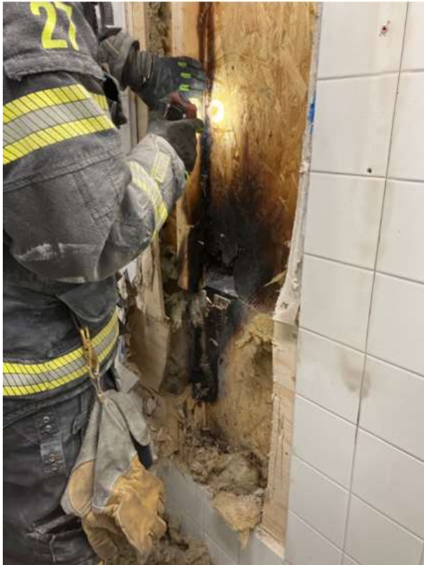
Figur 8. Brandskador i väggen sett från diskrummet.
