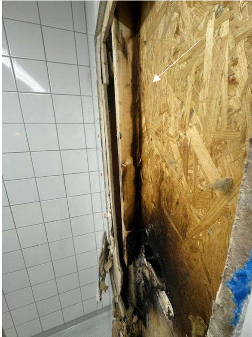
Figur 17. Brandutsatt vägg där kolad regel syns. Bild tagen av hantverkare, från diskrummet.
