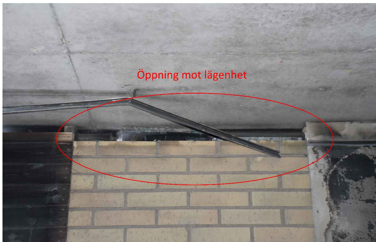
Figur 41. Bild som visar öppning mot lägenhet, bild tagen från korridor K2
