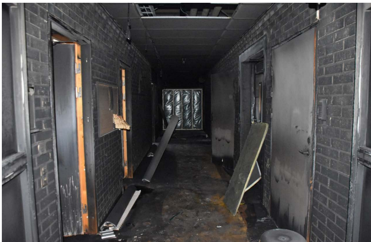
Figur 22. Foto som visar korridor K8, tillfällig vägg i korridorens slut är uppförd mot det som tidigare var dagverksamhetens lokaler
