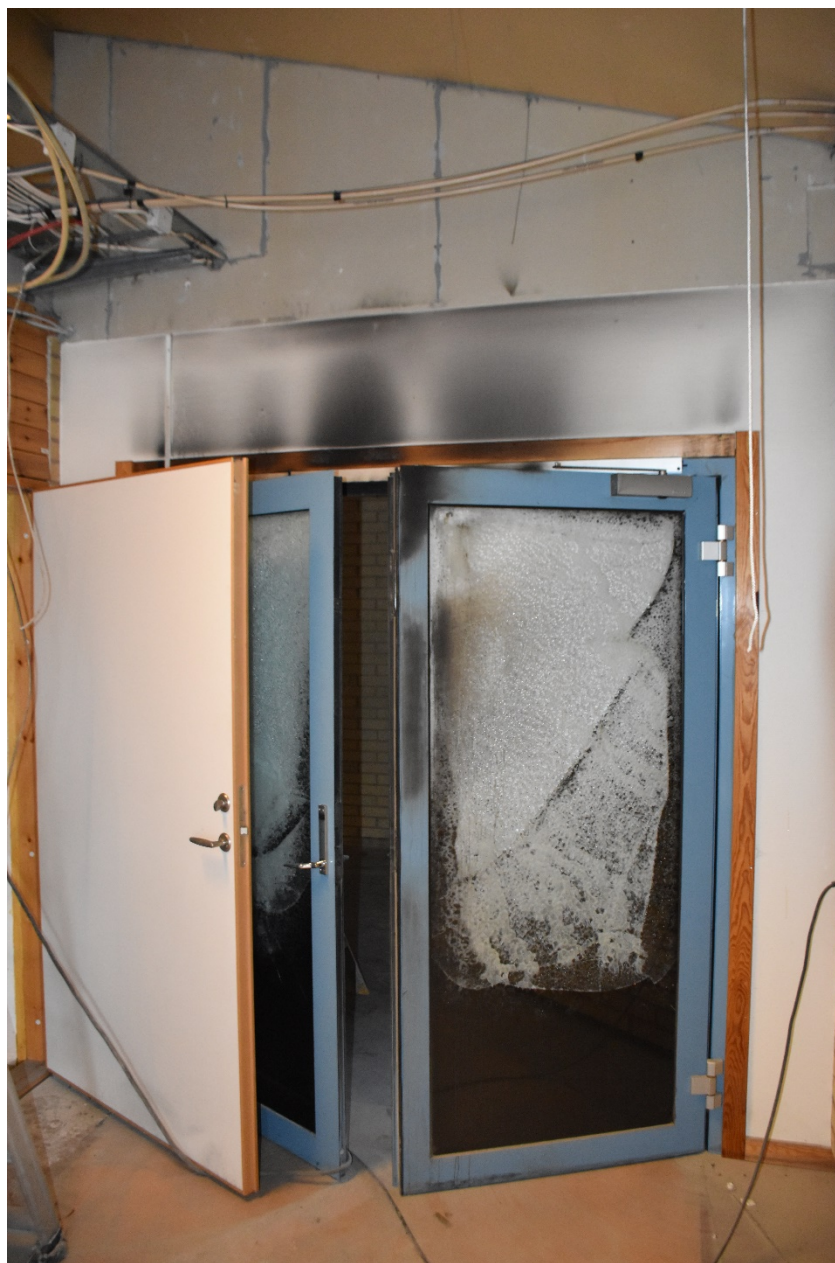
Figur 28. Branddörr mellan korridor K4 och K2.
