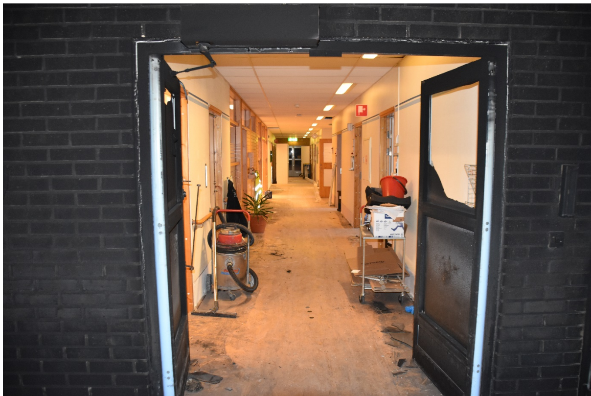
Figur 24. Dörr mellan korridor K2 och rehabavdelningen, glaset i den högra dörrhalvan har förstörts ytterligare av räddningstjänstens rökdykare.
