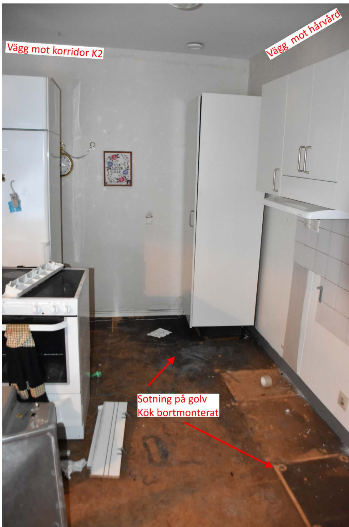
Figur 37. Foto från lägenhet som visar sotning på golvet samt under skåpsstommar till köket
