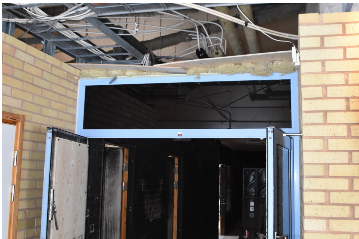
Figur 27. Dörr mellan korridor K4 och K8, oklassad dörr och öppet ovan undertak.
