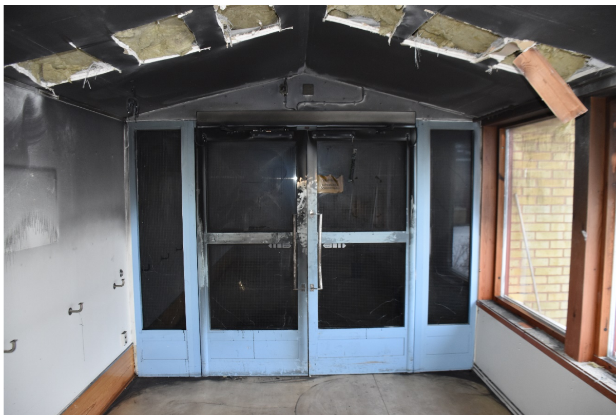
Figur 34. Branddörr mellan korridor K2 och K5, sedd från korridor K5
