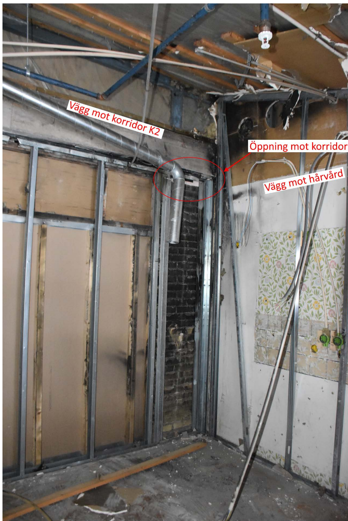
Figur 39. Bild som visar otäthet mot korridor K2, sotning i väggkonstruktionen tyder på rökfylld
