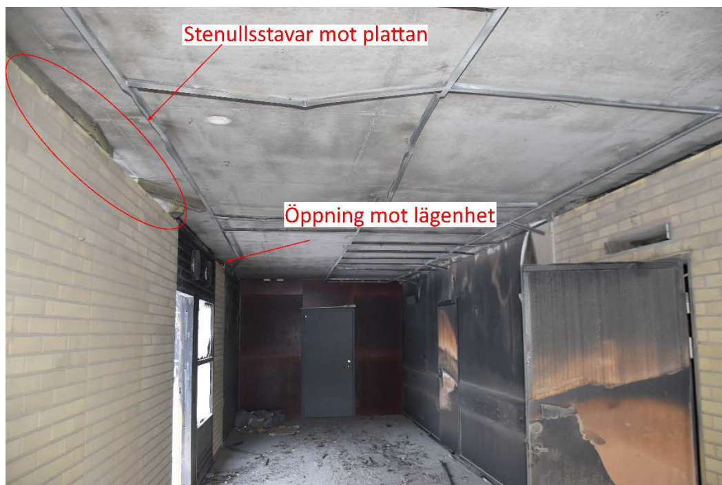
Figur 43. Visar korridor K2 med öppning mot lägenhet och tätning med stenullsstavar
