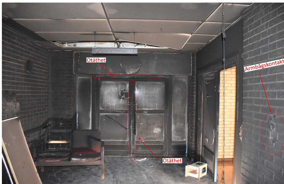
Figur 33. Branddörr mellan korridor K2 och K5, sedd från korridor K2
