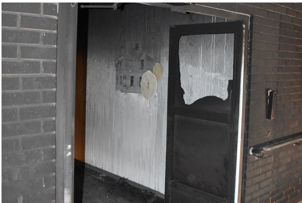
Figur 21. Foto som visar dörr mellan korridor K2 och K3, med trasigt glasparti
