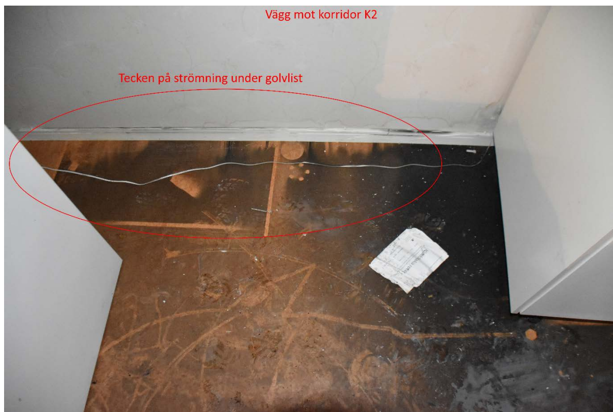
Figur 38. Bild som visar sotning på golv och tecken på att brandgaser strömmat under golvlister.
